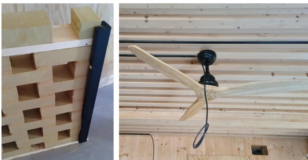
Image 5 : Montage des moucharabiehs microclimatiques – « radiateur froid » et des brasseurs d'air.
