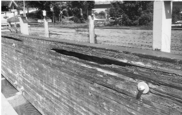
Genauere Aufnahme u. Dokumentation der Schäden
