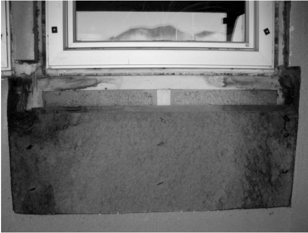
Abbildung 3: Erheblicher Schaden am WDVS und der Holzkonstruktion aufgrund undichter WDVS Anschlüsse zum Fenster und zur Fensterbank; die dunklen Flecken zeigen die bereits zerstörte Holzfaserdämmplatte
