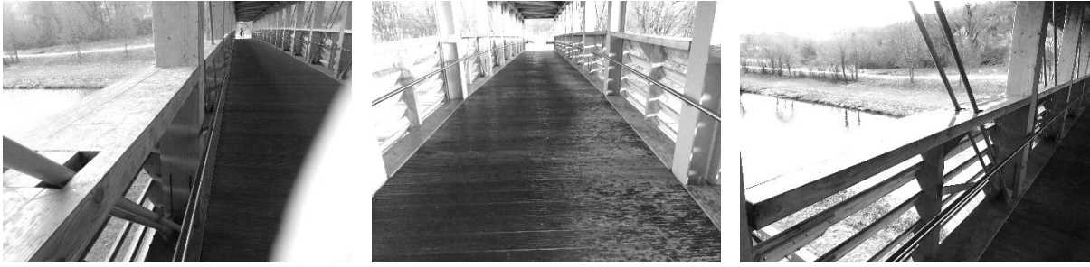
Abbildungen 19-21: Befeuchtung bis an die Innenkante bei leichtem Regenfall; Wind von rechts – gegenüberliegende Seite komplett nass; Stehendes Wasser, Quelle: Schmees & Lühn
