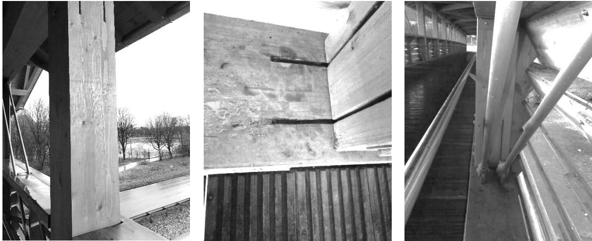
Abbildungen 22-24: Fachwerkpfosten auf 2/3 der Höhe befeuchtet; Stehendes Wasser im Bereich der Knotenbleche; Herabtropfendes Wasser vom Handlauf und den Zugstangen, Quelle: Schmees & Lühn
