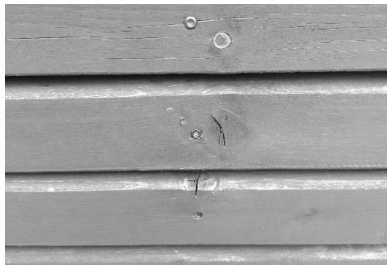
Abbildung 10 Fasadenschalung mit einer Vorvergrauungslasur behandelt, Speziell die Kantenbereiche erscheinen relativ ungleichmäßig und die Lasur wird flächig abgebaut.
