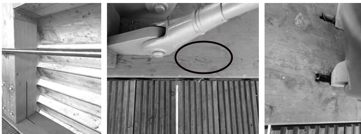
Abbildungen 16-18: Verstärkte Wasserspuren unterhalb der Lamellenschalung; «Abschlüferung» der äußeren Holzfasern am Untergurt; Dreck- und Feuchtespuren im Bereich der Knotenbleche am Übergang des Zugstabes in den Untergurt, Quelle: Schmees & Lühn
