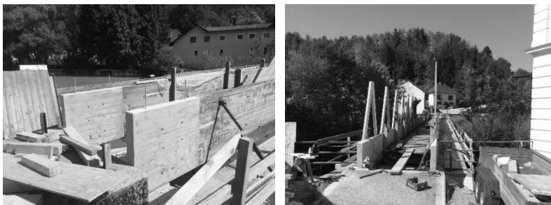
Betonprothesen an allen 4 Auflagern
