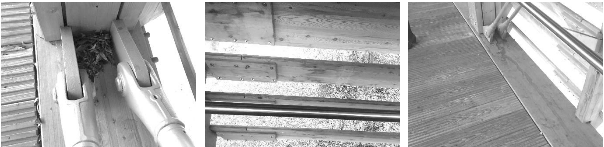
Abbildungen 13-15: Laubansammlungen im Untergurtbereich; Wasserspuren hinter der Lamellenschalung; Wasserspuren auf dem Untergurt, Quelle: Schmees & Lühn
