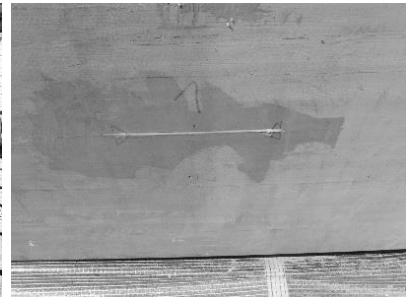
Die wetterabgewandte Seite ist wesentlich besser, nur geringe Schädigung
