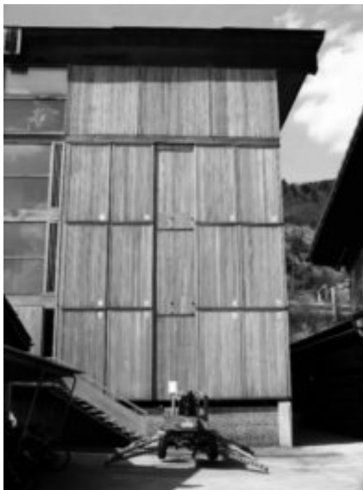
Abbildung 6: Südseite der Fachhochschule in Biel nach 9 Jahren Bewitterung und anschließender Reinigung
