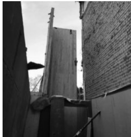
Abbildung 33b: Aufzugschacht in BSP-Holz [Seibel Architektur Consult]
