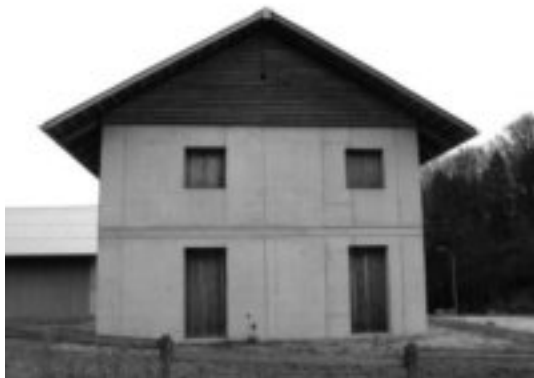
Abbildung 3: Unbehandelte Stülpschalung - Fichte (westexponiert), nach 5 Jahren Bewitterungszeit, die erwartete Vergrauung ist relativ gleichmässig abgesehen vom Einfluss des Vordaches (Volkmer und Höltschi 2008)
