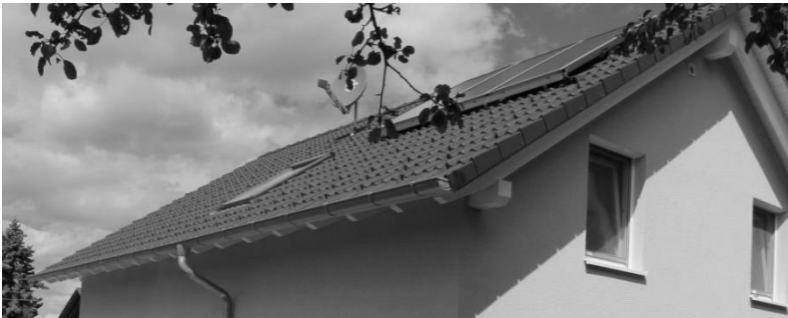
Abbildung 1: Negativ: Farbe, Ausrichtung, Dachneigung, Dachfenster
