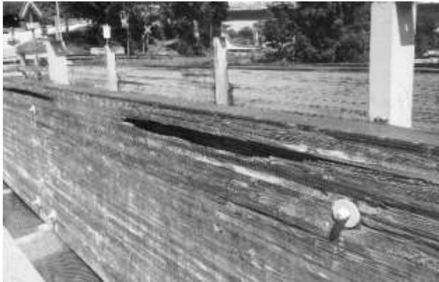
Genau Aufnahme u. Dokumentation der Schäden
