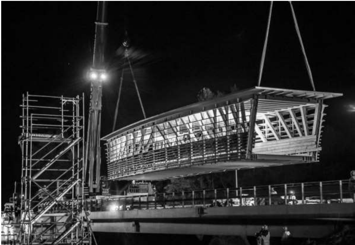
Abbildung 13: Einhebevorgang der Holzbrücke. Vom Start der Arbeiten in der Montagehalle bis zum Versetzen vergingen nur rund zwei Monate (Quelle W. Vogelsang).
