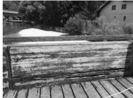
Schwer beschädigte Träger neben dem Gerberstoß an der wetterzugewandten Seite
