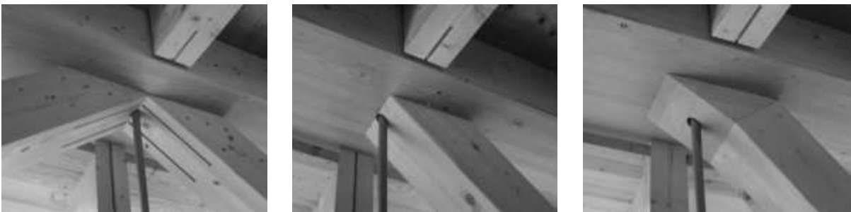
Abbildung 7: Vielfältige Verbindungen mit Schlitzblechen in Brückenmitte, über einen einfachen Versatz im Verlauf der Brücke bis hin zu Eichensätteln im Auflagerbereich (Quelle JP. Ammann).
