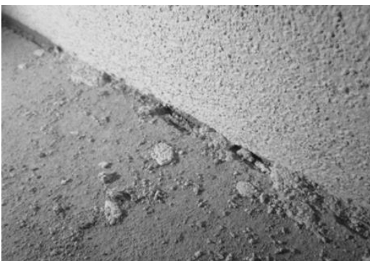
Abbildung 3: Beispiel von Fuge zwischen Wand und Zementestrich mit Abrieb
