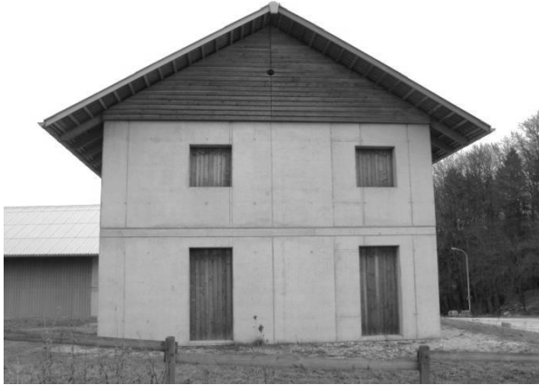
Abbildung 3: Unbehandelte Stülpchalung – Fichte (westexponiert), nach 5 Jahren Bewitterungszeit, die erwartete Vergrauung ist relativ gleichmässig abgesehen vom Einfluss des Vordaches (Volkmer und Höltschi 2008)
