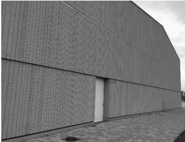
Abbildung 9: Fassade – behandelt mit einer Vorvergrauungslasur, Die Oberfläche wirkt sehr natürlich und ist kaum von einer unbeschichteten, bewitterten Fassade zu unterscheiden.
