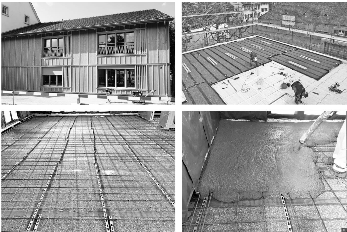
Abbildung 11: oben: Doppelkindergarten Sissach, I.: Ansicht r.: Holzlage der HBV-Decke © Beer Holzbau AG unten: Bewehrte Granulatsplitt-Rohdecke vor und während der Betonage © Lignotrend
