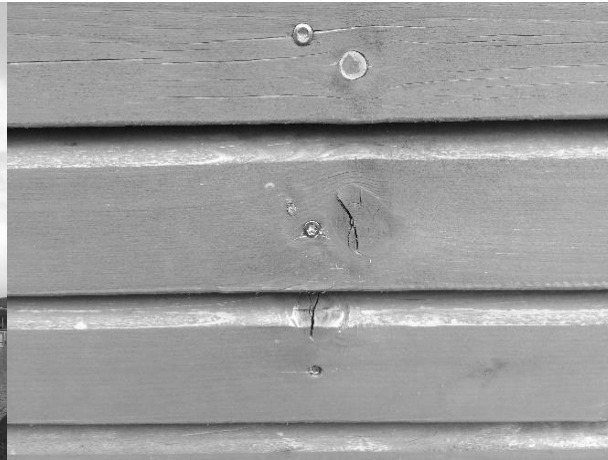
Abbildung 10: Fasadenschalung mit einer Vorvergrauungslasur behandelt, speziell die Kantenbereiche erscheinen relativ ungleichmässig und die Lasur wird flächig abgebaut.
