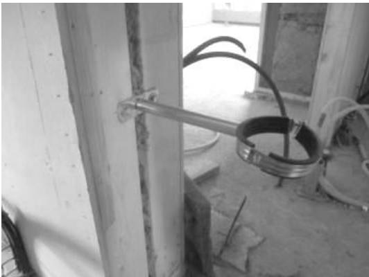
Abbildung 4: Beispiel der falschen Befestigung der Rohrschelle an der zwei-schaligen Trennwand
