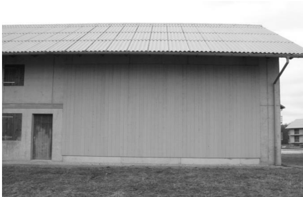
Abbildung 14: Fassade mit Dickschichtlasur ostexponiert nach 5 Jahren Nutzungsdauer, die Erscheinung ist sehr gleichmässig (Volkmer und Höltschi 2008)
