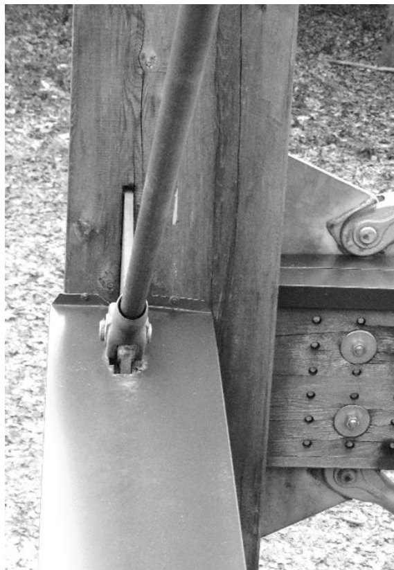
Abbildung 13: Ausführung des Anschlusses ungenügend (nicht von WIEHAG ausgeführt)
