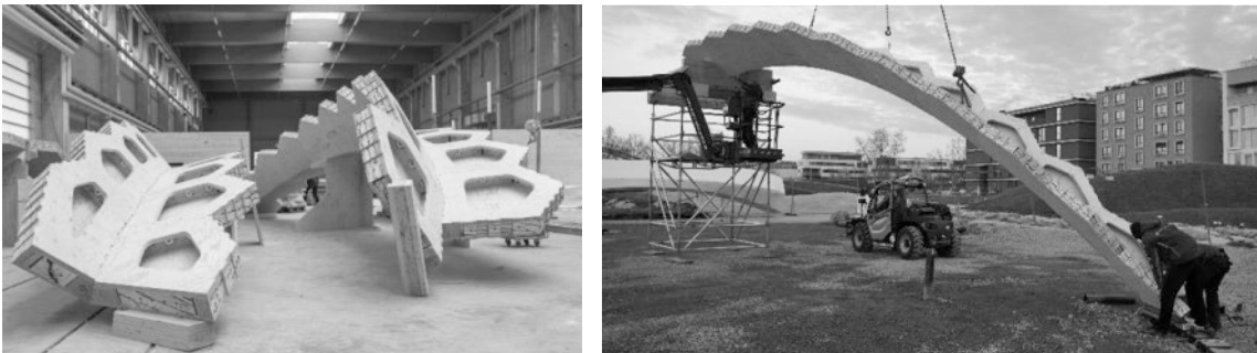
Abbildung 9+10: Vorfertigung der Halbbögen im Werk von Müller Blaustein Holzbauwerke und Aufbau vor Ort und Aufbau vor Ort
