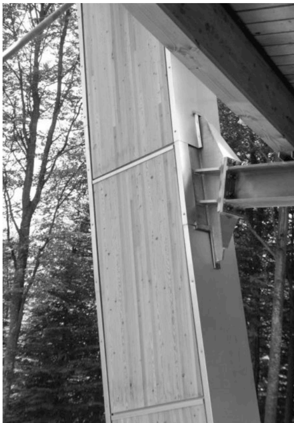
Abbildung 12: Korrekte Ausführung des Anschlusses (von WIEHAG ausgeführt)
