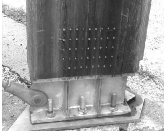
Abbildung 9: Abstand zur wasserführenden Ebene ungenügend (nicht von WIEHAG ausgeführt)
