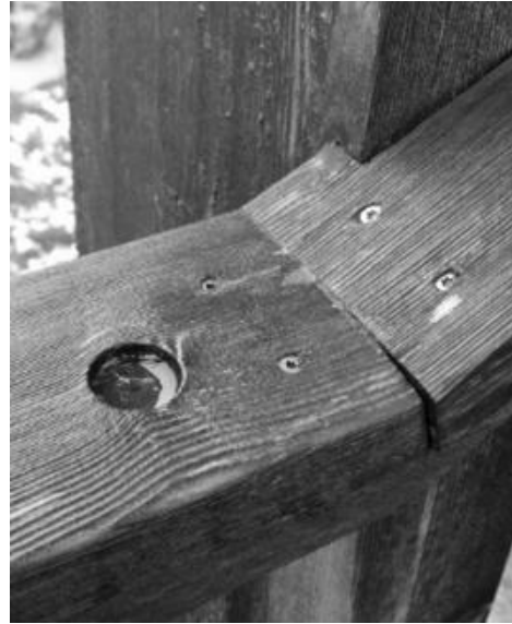
Abbildung 17: Wassersackbildung bei Ausbesserung (nicht von WIEHAG ausgeführt)
