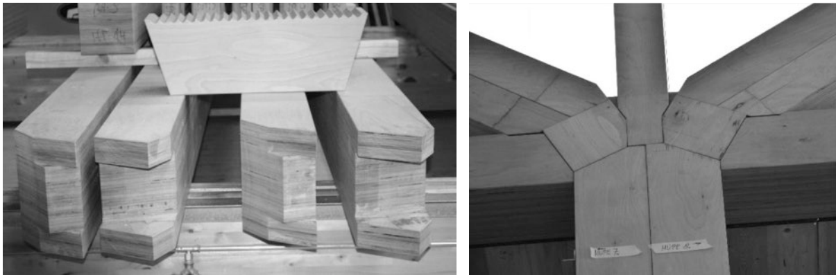
Abbildung 7: Rechts: Abbund der Diagonalen und der zugehörigen Knagge des Mittelauflegerknotens; Links: montierter Knoten.
