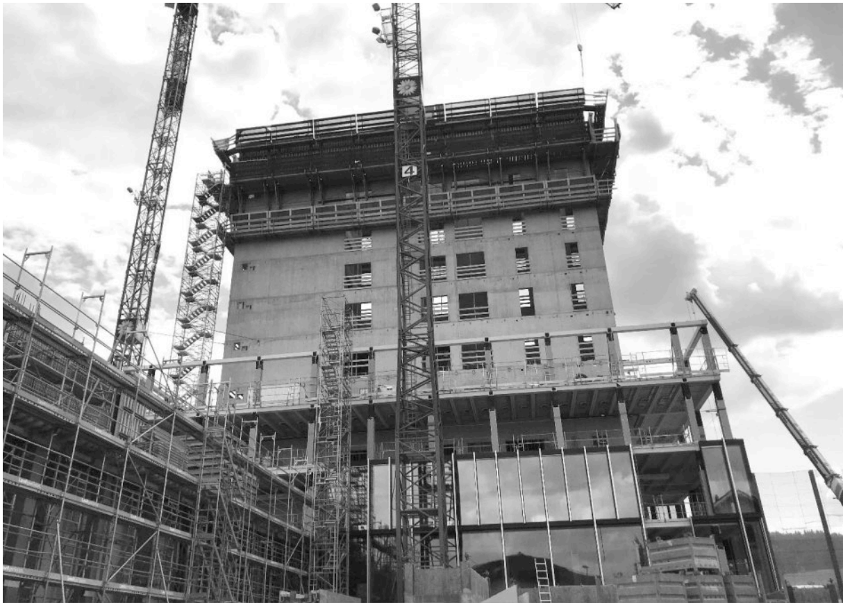
Hintereinander Bauen, Kern mit Gleitschalung, Holzbau folgt im 4 Wochen-Rhythmus, Fassade folgt Holzbau
