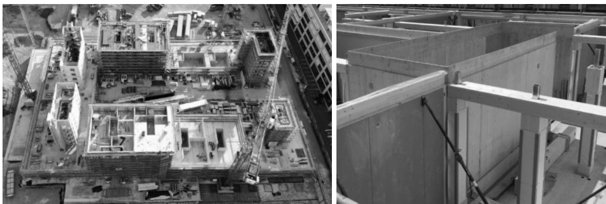
Abbildung 8 und 9: Luftbild der Holzbaumontage vom 05.07.2019. Gut sichtbar der vormontierte Holzbau um die Treppenhäuser.
