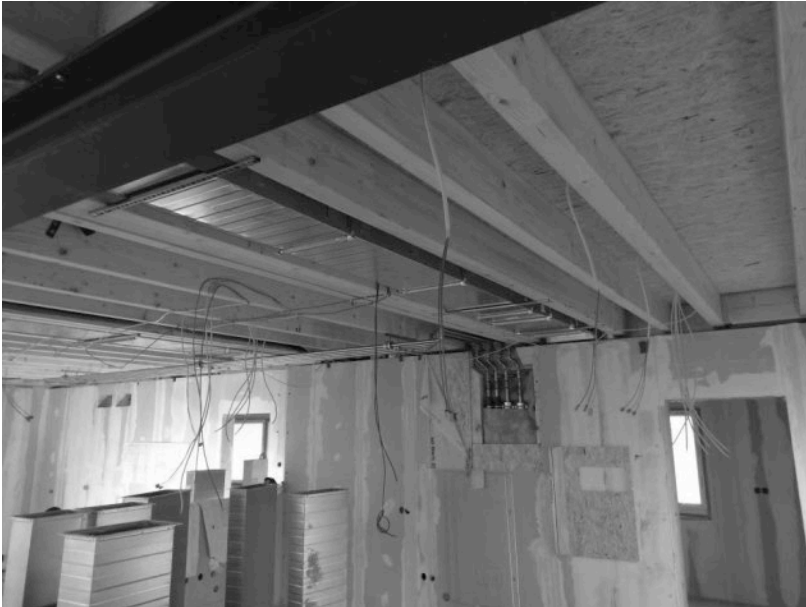
Abbildung 6: Verzug von Luftkanälen in der Flucht der Deckenbalken
