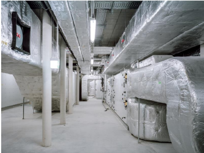
Abbildung 1: Technikzentrale im Schulgebäude in Diedorf (ARGE Nagler & Kaufmann Architekten)
