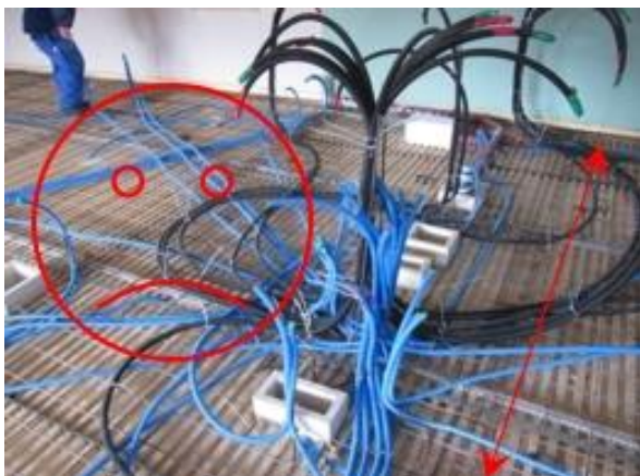
Abbildung 5: «Leitungsführung» auf Decke
