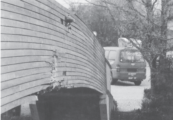
Abbildung 4: Passarelle Schiffen nach LKW-Anprall
