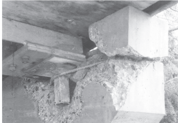
Abbildung 5: Betonwiderlager der Passarelle Schiffen nach LKW-Anprall
