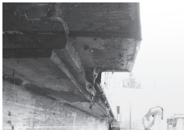
Abbildung 14: Ungenügende Ausbildung der Tropfkante mit deutlicher Auffeuchtung
