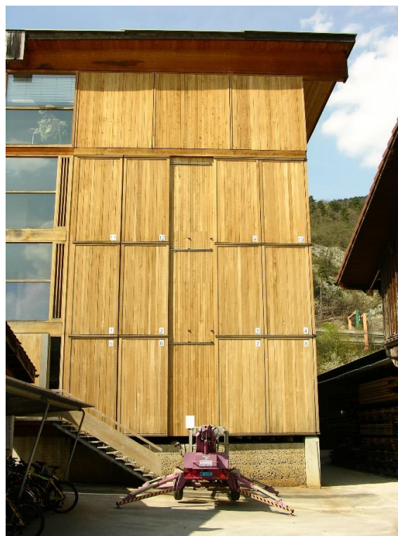
Abbildung 6: Südfassade der Fachhochschule in Biel nach 9 Jahren Bewitterung und anschließender Reinigung
