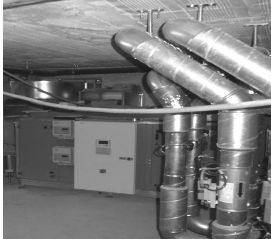
Abbildung 5: Lüftungszentrale im Keller
