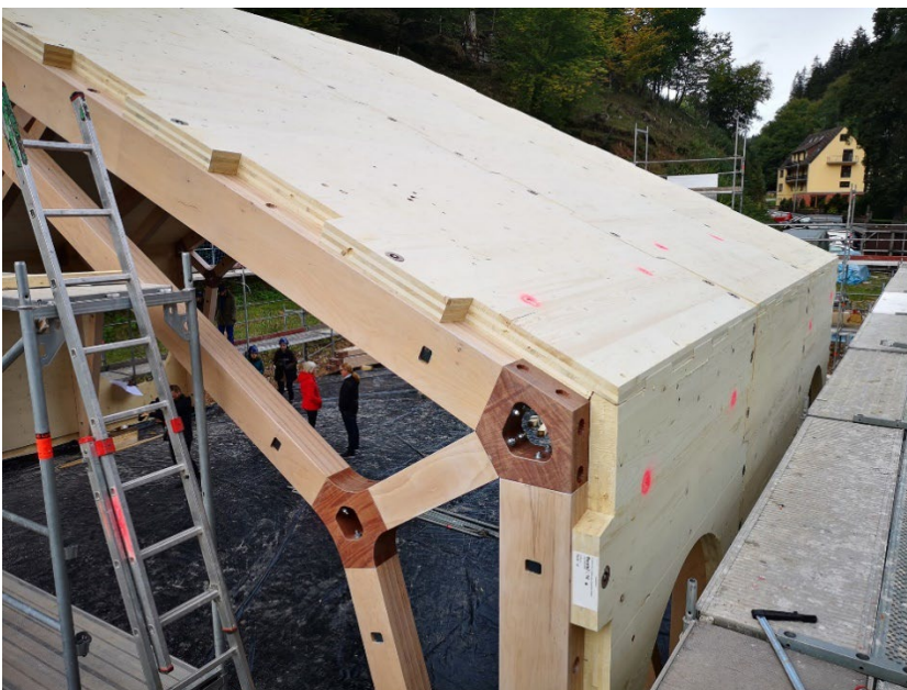
Abbildung 13: Werk- und Forschungshalle: Bauphase – Reversible Verbindungen aller Bauelemente mit formschlüssigen Verbindungen, z. B. mit Konusadaptern
