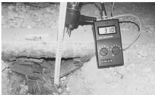
Abbildung 4: Zersetzung aufgrund zu hoher Holzfeuchte, [5]
