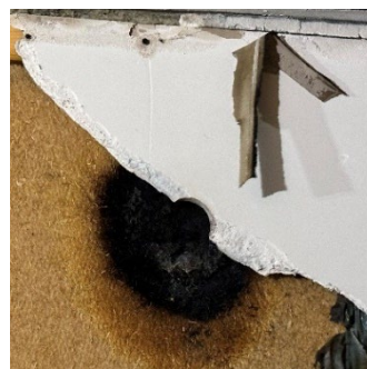
Abbildung 10: Entzündeter Dämmstoff hinter Brandschutzbekleidung mit Öffnung für Hohlwanddose.
