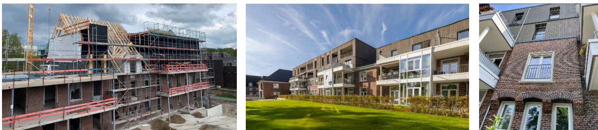
Abbildung 5: Bild links; Montagezustand Aufstockung (© Holzbau Gehrman), Bild rechts; fertiggestellte Aufstockung (© DeepGreen Development)
