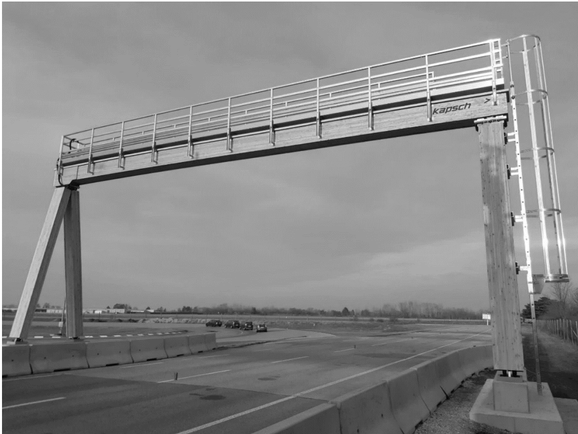
Abbildung 2: Bild der im Februar 2023 in Betrieb genommenen Prototypenanlage
