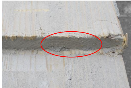
Stauchung der Holzfasern Schubträger 40.3
