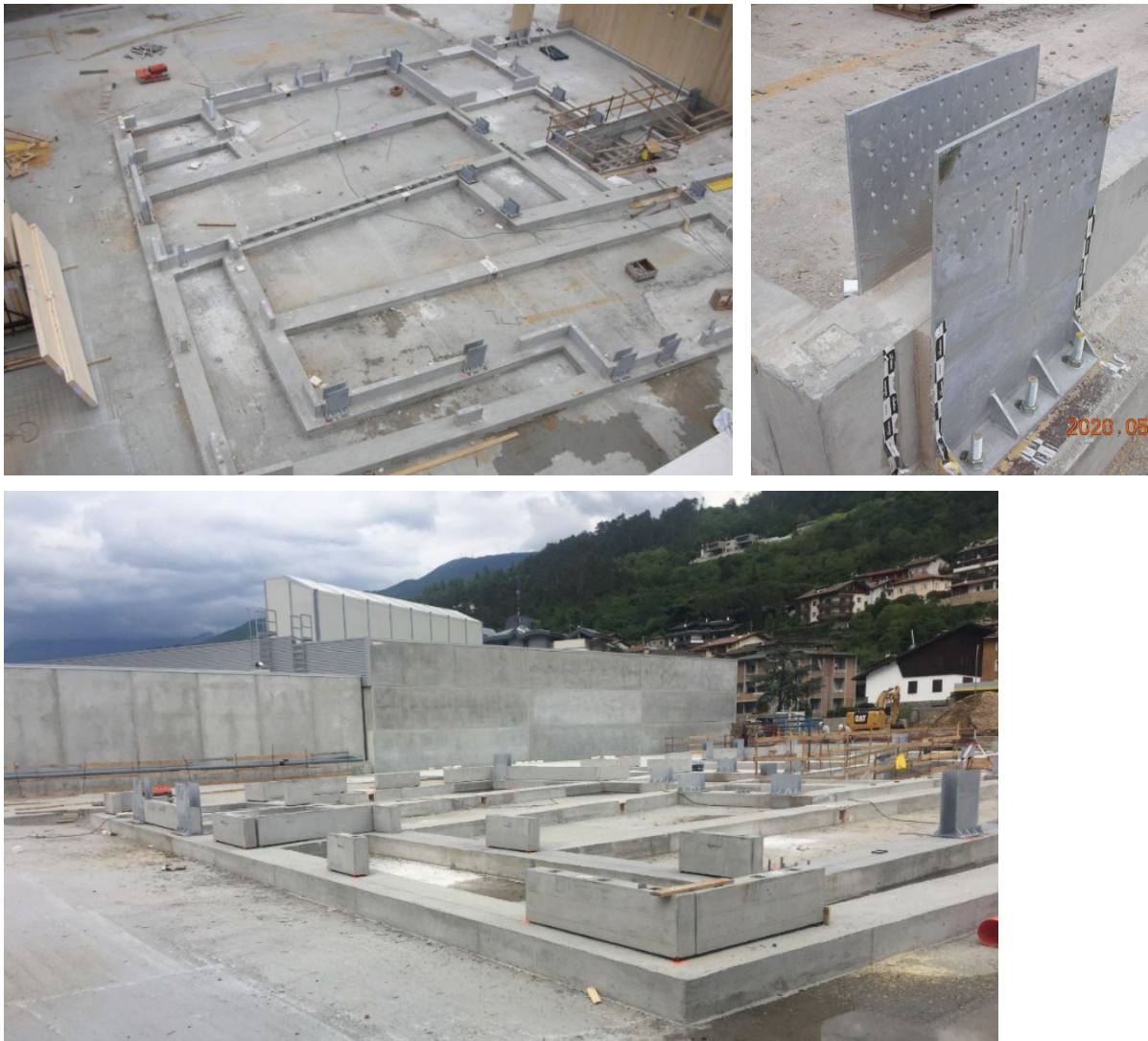
Bases de arranque en el suelo
