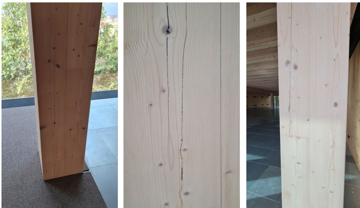
Ilustración 19: fendas aparecidas en pilares
