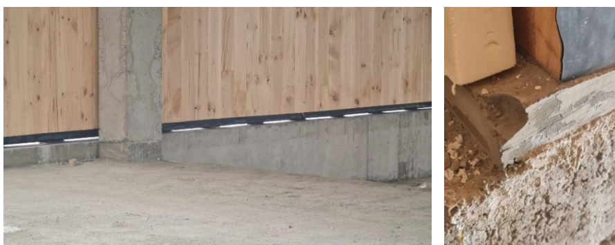
Ilustración 15: desniveles de hasta 5 cm en apoyo de CLT sobre hormigón; relleno con mortero sin retracción
