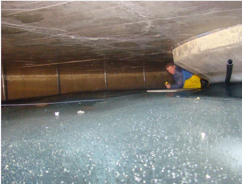
Abbildung 10: Eisbildung im Eisspeicher (Copyright Viessmann)
