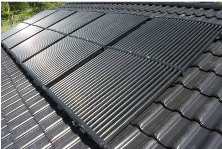
Abbildung 7: Absorber-Kollektoren auf einem Satteldach
