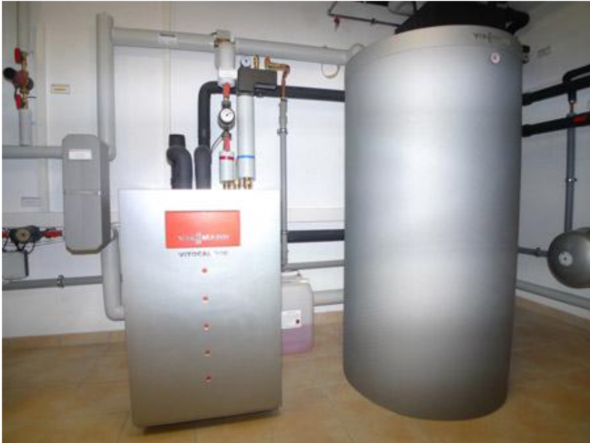
Abbildung 8: Wärmepumpe mit Pufferspeicher
