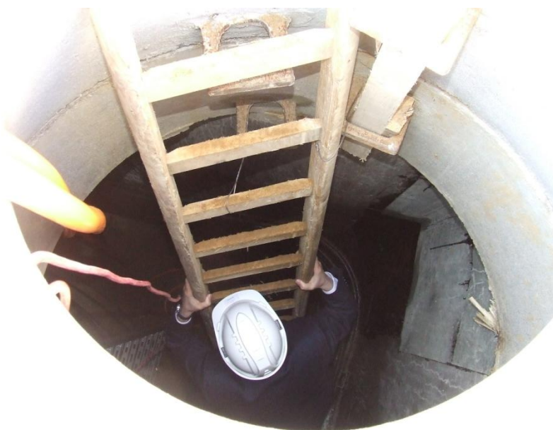
Abbildung 5: Der Einstieg in den Eisspeicher
