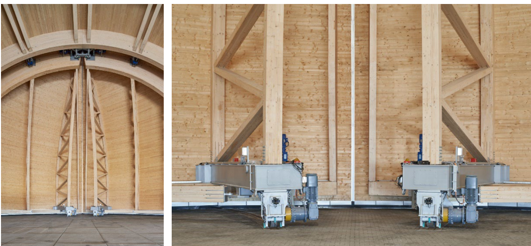
Abbildung 3: Die Torflügel gleiten auf viertelkreisförmigen Schienen zur Seite.
