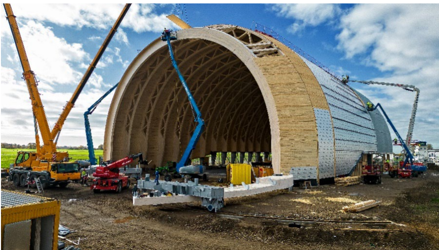
Abbildung 6: Obgleich der aufwendigen Handarbeit konnte die Bauzeit unter anderem durch einen hohen Vorfertigungsgrad enorm verkürzt werden.
