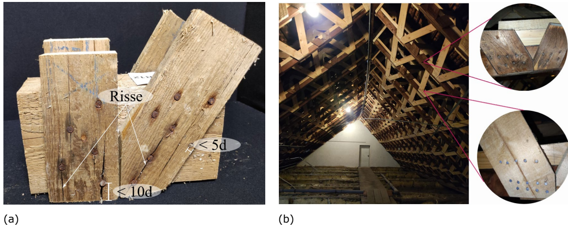
Abbildung 2: (a) Knoten mit zu geringen Randabständen und einzelnen Rissen (b) Sanierung durch Austausch von Diagonalen
