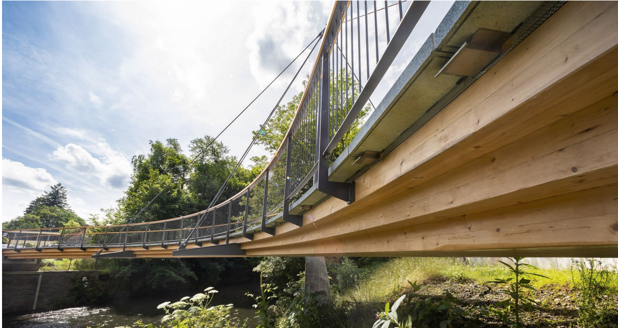
Abbildung 7: Gut erkennbar: Edelstahlrinnen unter den Plattenstößen garantieren Querentwässerung
