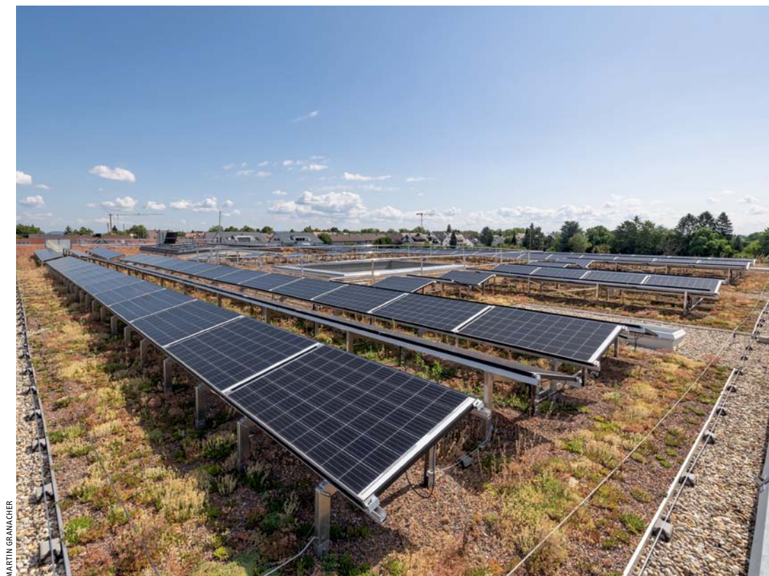
▲ Die Photovoltaik-Module auf dem Gründach leisten einen Beitrag zur umweltfreundlichen Energieversorgung des Schulzentrums
